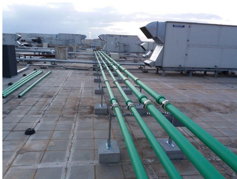
Νέα δίκτυα κλιματισμού
