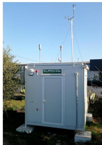
Εικόνα 6: Μόνιμος σταθμός μέτρησης
