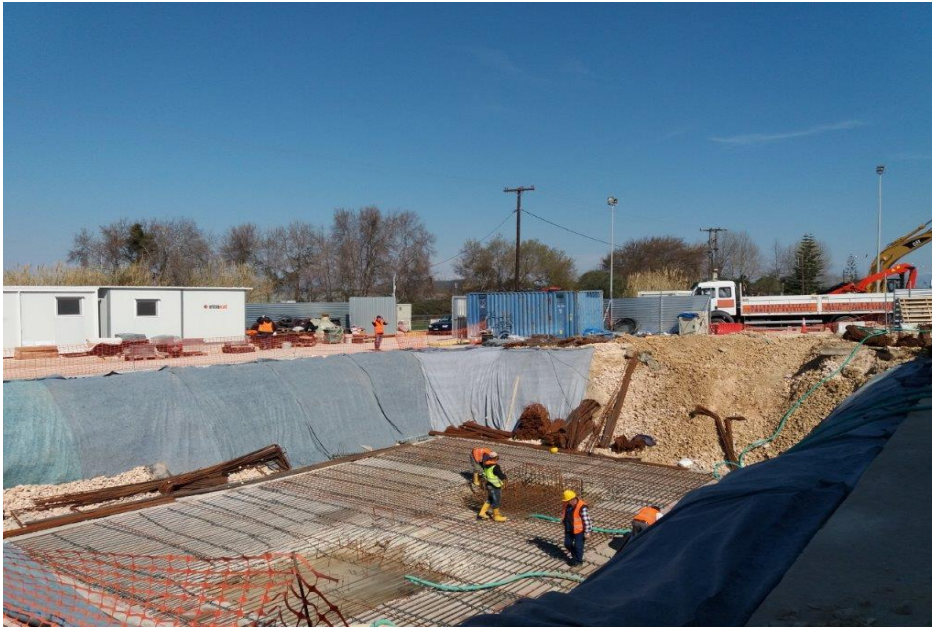
Νέα δεξαμενή πυρόσβεσης
